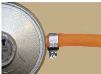
Slanganslutning vid reduceringsventil. Foto: MSB
